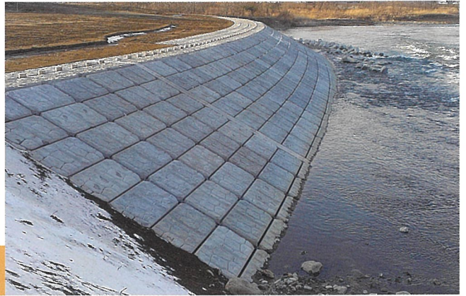
ロックボードW 東北地方整備局 阿武隈川
