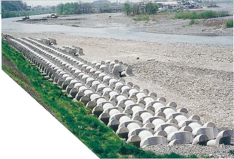
北陸地方整備局 千曲川工事事務所 犀川4ton 根固・水制工
