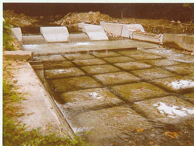
岩手県 大東町役場 2ton型(基本タイプ)43型・50型 「菅の沢(頭首工)災害復旧工事」
