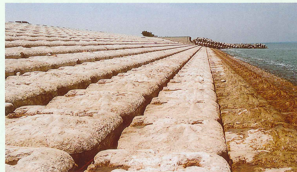
北陸地方整備局 黒部河川事務所 「柳原緩傾斜堤災害復旧工事」
