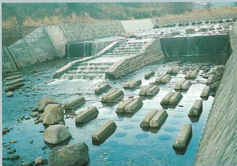
福島県 県南建設事務所 堀川 2 ton ベンチ護床工・NP魚道ブロック
